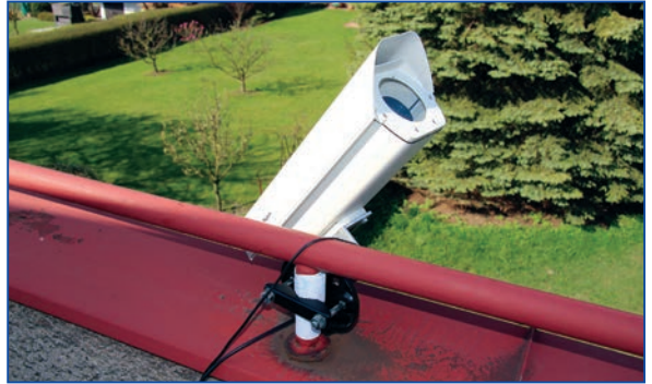
Kamera systému NFC na střeše odborného pracoviště.
