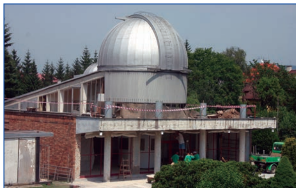
Netradiční pohled na hlavní budovu hvězdárny v době havarijní rekonstrukce v roce 2013.
